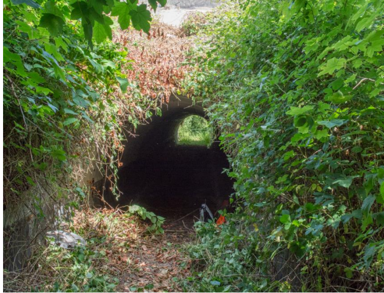
Figure 97 : photo montrant l'ouverture sud du passage inférieur après coupe de la végétation. Ainsi la covisibilité est rétablie. Photo : cc-by-sa-3 O. Pichard
