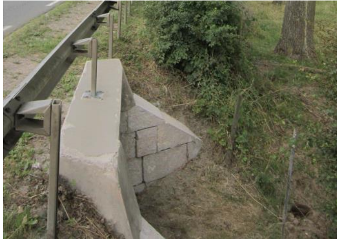
Figure 77 : vue de la sortie de l'ouvrage au nord débouchant sur une clôture barbelée 3 fils. Photo : J. Bacquaert, CD62
