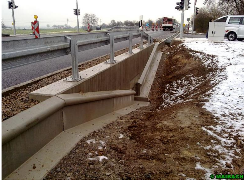
Figure 37 : système de guidage fait d'un muret béton pour diriger des amphibiens vers un batrachoduc. Source : Maibach.com
