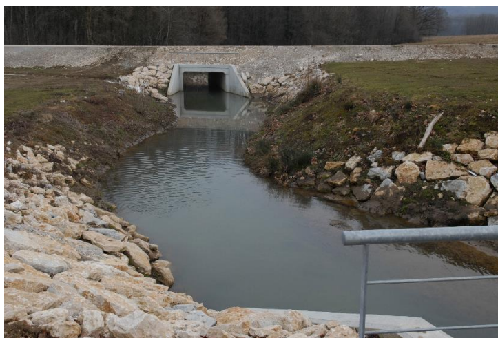
Figure 31 : Passage submergé pendant de fortes pluies à Cubry empêchant la faune terrestre d'emprunter le passage inférieur (Source : RFF – LGV Rhin Rhône)
