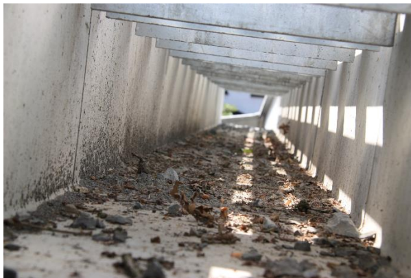
Figure 56 : Batrachoduc avec plafonnier ouvert, (Source : CC-BY-SA : Nabu Oberberg)
