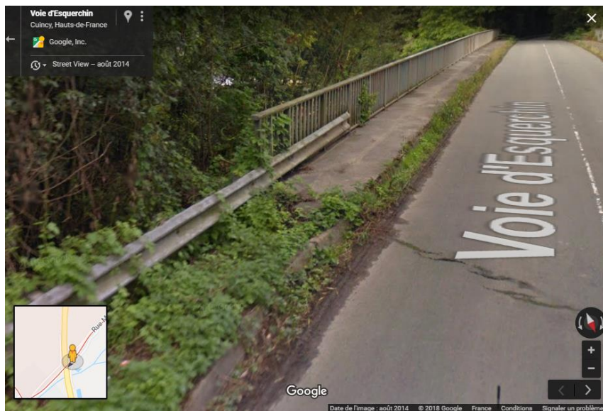
Figure 86 : extrait de carte Google Street View montrant la zone de transition entre le terrain naturel et l'enrobé du trottoir de la voie d'Esquerchin. (Source : Street View – Date de l'image : août 2014 ©2018 Google)
