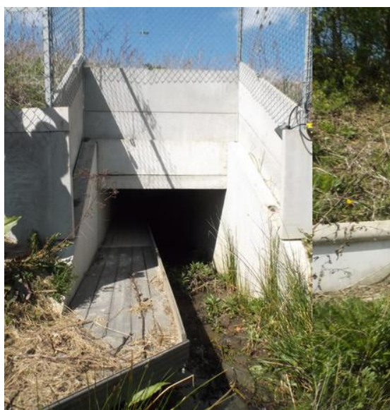
Figure 33 : Passage à faune équipé d'une banquette en bois à Frocourt (Hauts-de-France)
