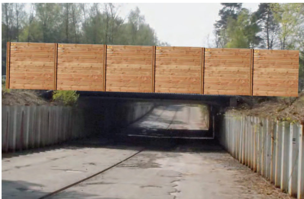
Figure 79 : Schéma de principe pour la pose d'écran occultants sur le parapet du pont.
