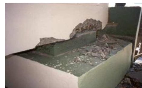
Endommagement de la structure au niveau d'un AA
