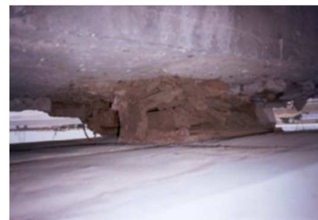
Destruction d'un AA métallique
