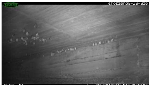
Photo infra-rouge d'une colonie de Grand Rhinolophes au Pont Rouge, à Guillestre, dans les Hautes-Alpes
