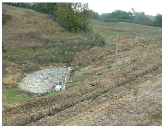
Maintenir hors de l'emprise clôturée les têtes d'OH utilisables par la faune
