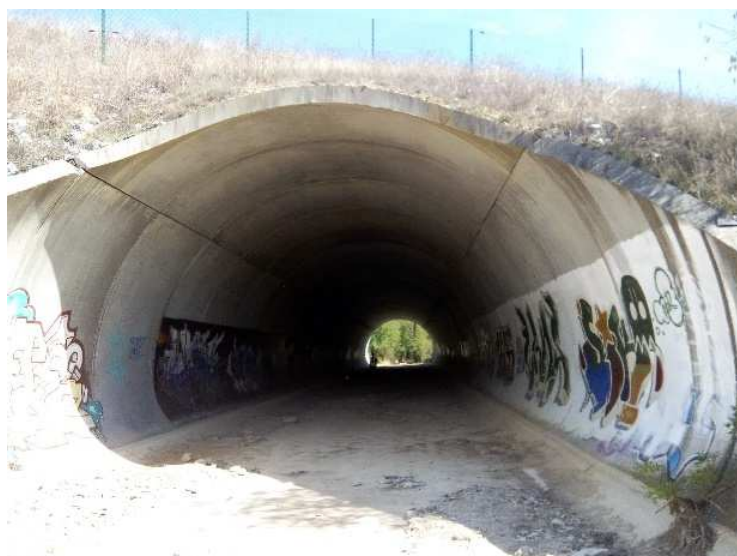
Graffitis dans un ouvrage hydraulique de la RN106
