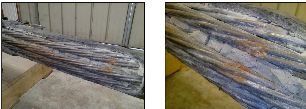
Figure n°24 : Foyers de corrosion à environ 20 cm de l'orifice
