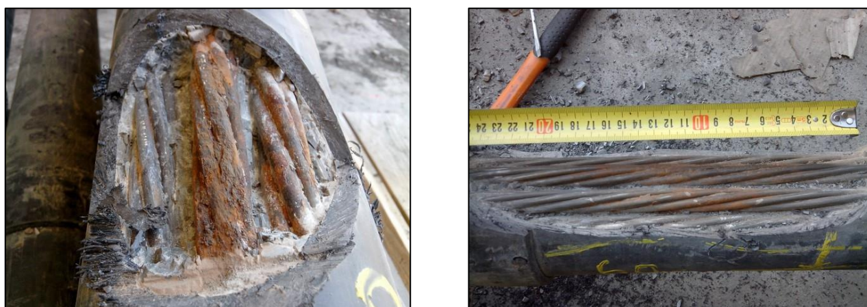
Figure n°23 : Zone de corrosion au droit d'un orifice non rebouché
