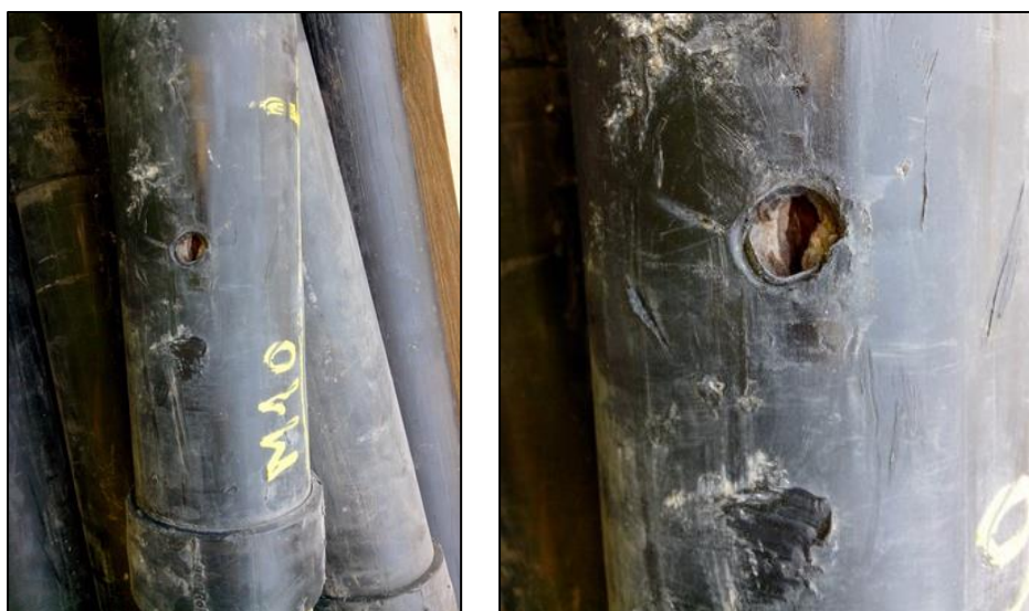
Figure n°22 : Orifice non rebouché
