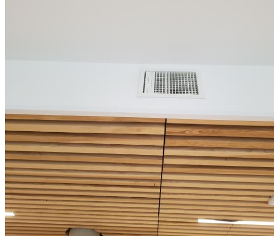
Figure 2 : Bouche d'insufflation Source : Cerema
