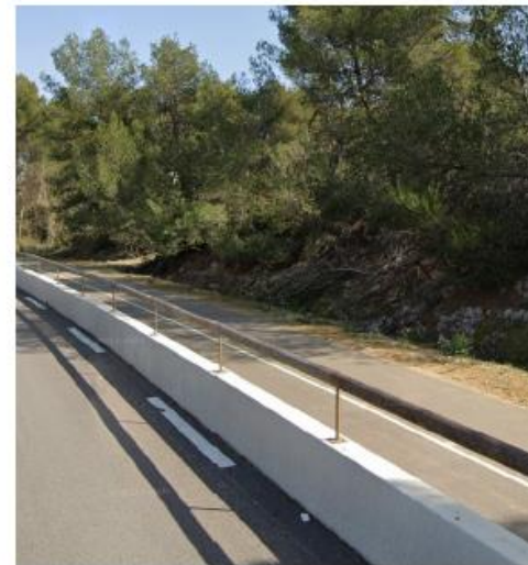
Exemple de séparation entre une piste et une chaussée par un muret VL surmonté d'une lisse bois
