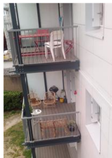
Figure 4 Val de Loire : traitement des ponts thermiques : remplacement des balcons par des terrasses autoportées
