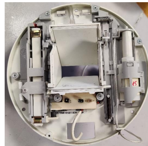
Terminaux de ventilation après maintenance
