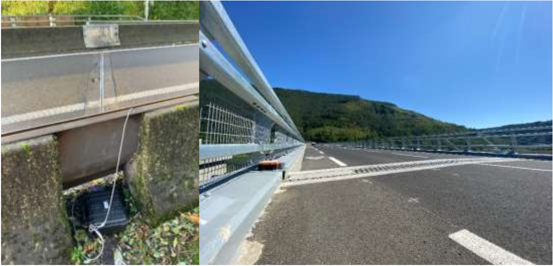
Valise d'enregistrement à Wasquehal (bretelle d'accès RN656 depuis Roubaix direction Lille), à gauche, et à droite : à Mende (Viaduc du Lot, N1088)
