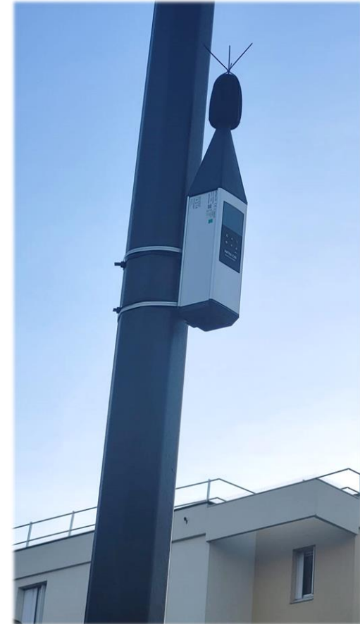
Sonomètre C50 installé sur site
