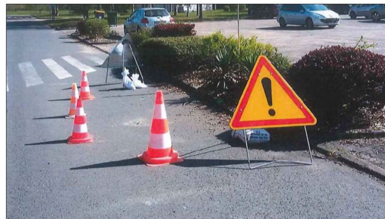
2017 - Affaissement au CNRS : diamètre ≈ 2 m, profondeur = 10 cm.
