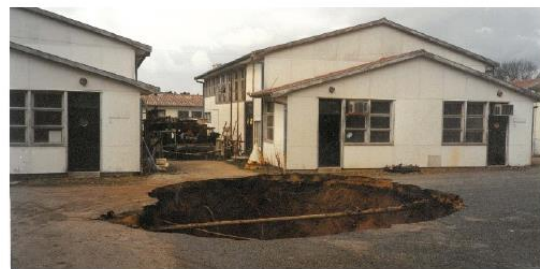
Bâtiment en situation critique (45) - M. Lepiller
