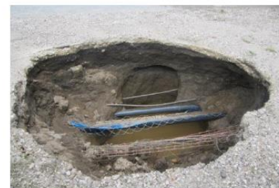
Canalisations proches de la rupture (45) - BRGM
