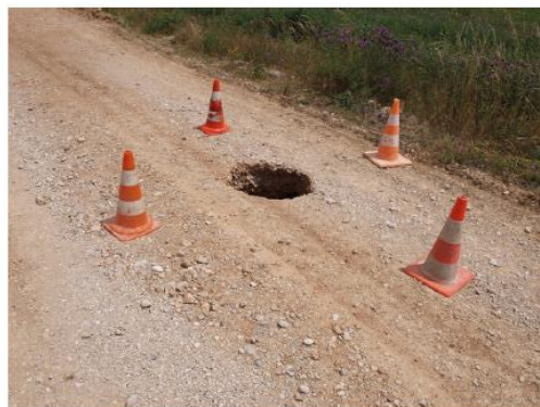
Effondrement associé à un soutirage proche de l'aire du Larzac de l'A75 (12) Cerema
