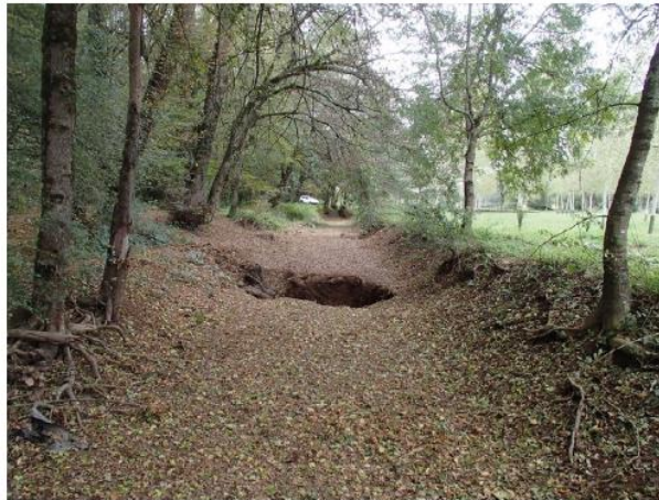
Effondrement dans le lit du Bandiat (16) - Cerema
