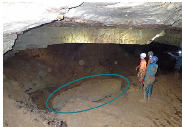
Chute de dalle du toit dans le réseau de La Fuié (16) – Cerema
