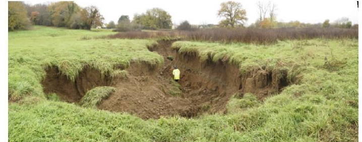
Effondrement sur les rives du Bandiat (16) - Cerema
