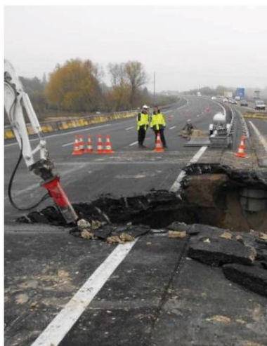
Trou dans une chaussée (45) - Cofiroute
