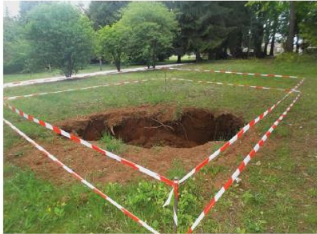
Effondrement à Thiviers (24) - Cerema
