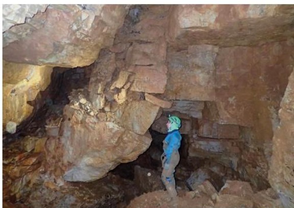
Zone bréchique instable dans le réseau de Camelot (16) - Cerema
