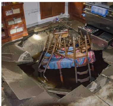
Rupture d'un dallage dans une maison (45) - BRGM
