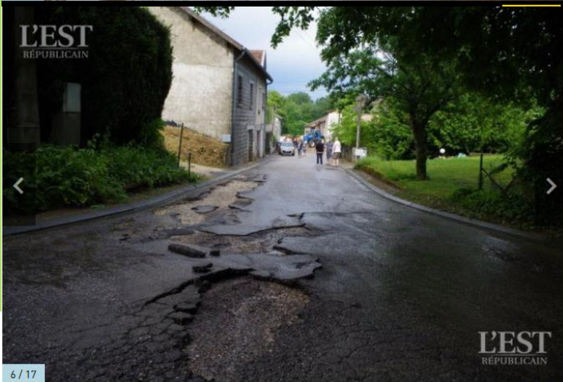
Le revêtement de la rue Fontaine Noë a été arraché par la fureur des flots.
