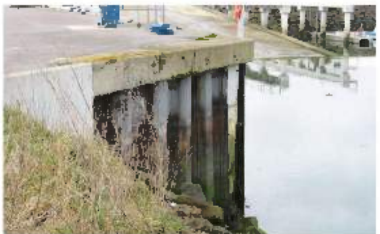
Figure 79 : mur de soutènement de terre-plein sur le port du Moulin-Blanc à Brest.
