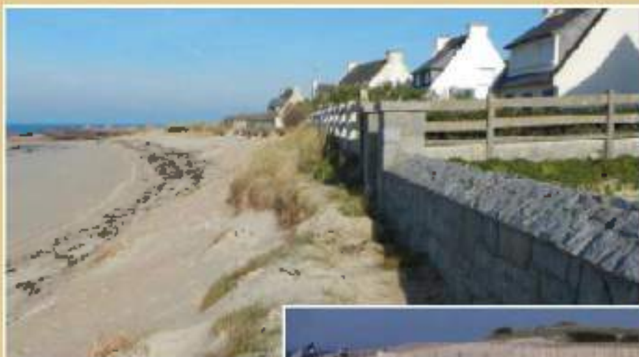
Figure 42 : état de la dune avant les travaux d'enrochements.
