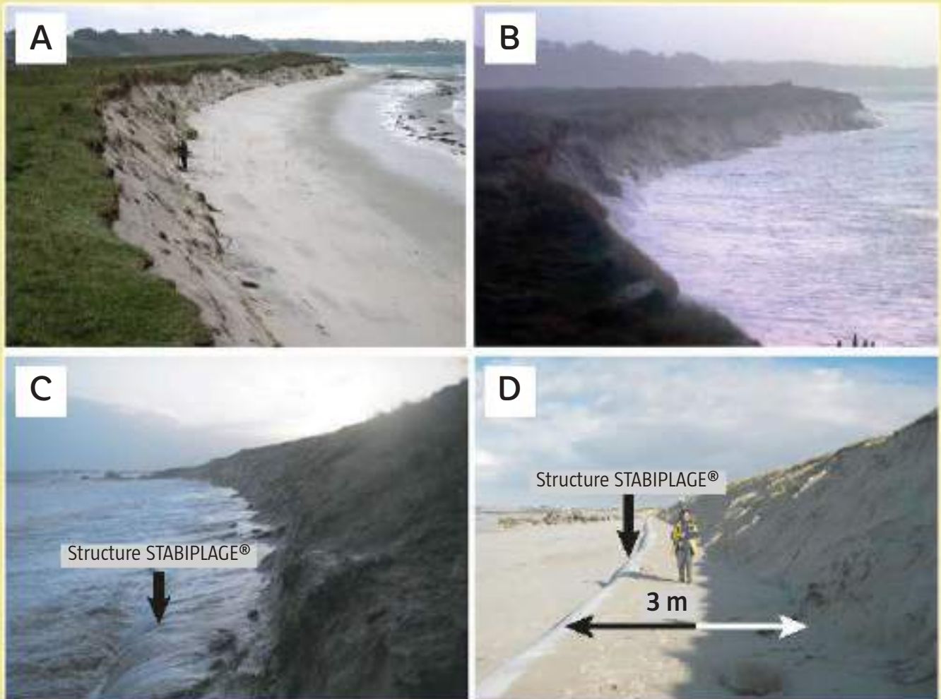
Figure 30 : boudin en géotextile avant et après la tempête du 10 mars 2008. A gauche : submersion durant la tempête du 10 mars 2008 ; à droite : recul du pied de dune d'environ 3 m après la tempête.
