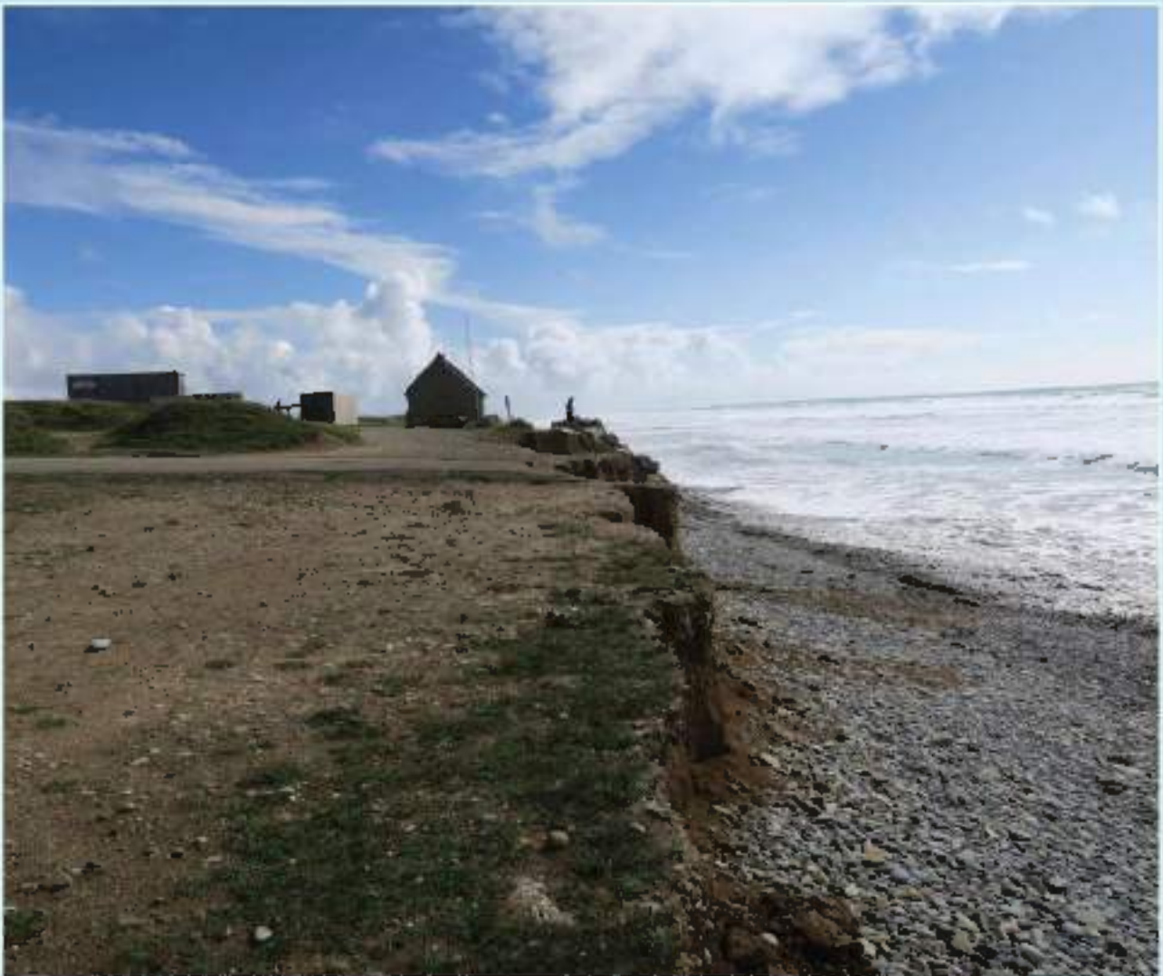
Figure 35 : vue du site depuis le nord, le 4 octobre 2021. L'érosion de la falaise accélérée par la pose de l'ouvrage se poursuit.
