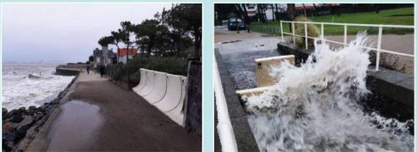
Figure 158 : digues amovibles en béton, à Saint-Brévin-les-Pins (44). (d'après WAVE BUMPER)
