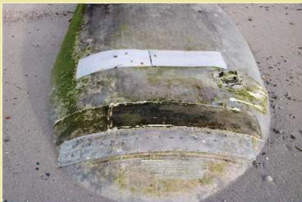
Figure 56 : dégradations et réparations sur un des épis en géotextile sur la plage de la Grève-Blanche au Guilvinec.
