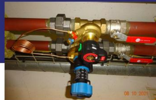
Vannes d'équilibrage en pieds de colonne de chauffage – lycée Chagall à Reims
