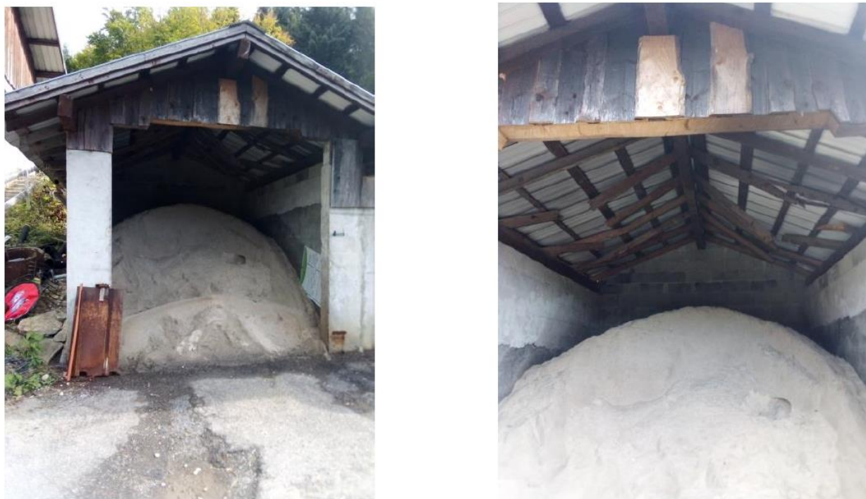
Figure 5: Exemple de stockage de sel avec toiture à réhabiliter
