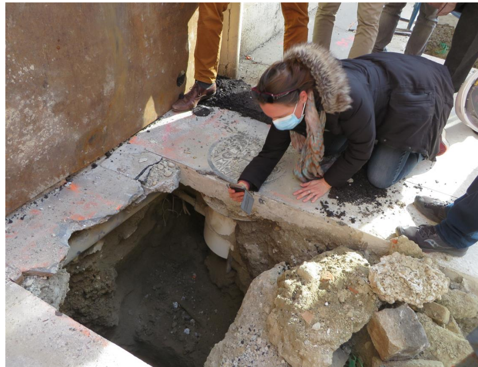
Fontis Lyon 1 er - découverte fortuite lors de travaux
