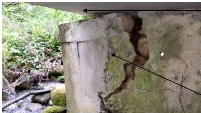
Fracture, décrochage d'une culée suite à affouillement
