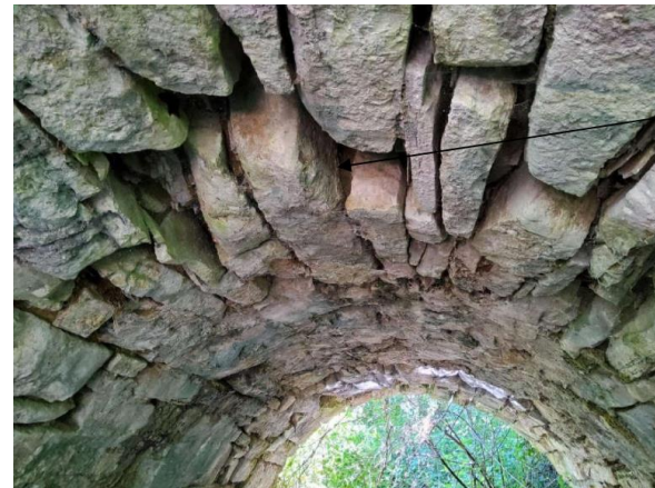
Disjoints très prononcés, lacunes, désorganisation
