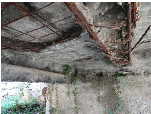
Altération profonde du béton armé
