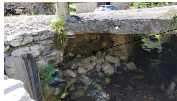
Effondrement partiel de la culée
