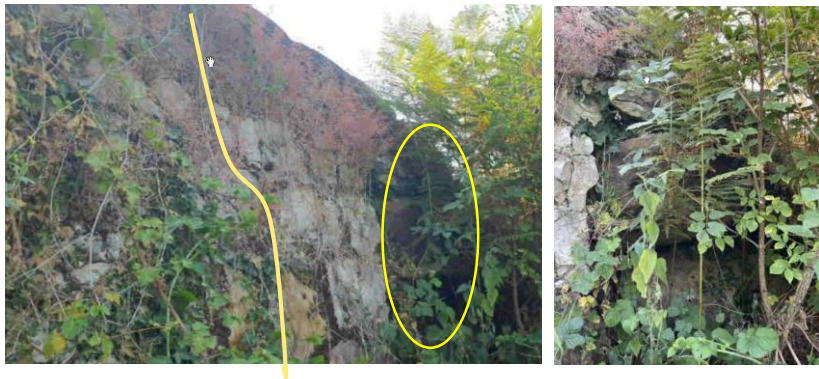
Bombements et partie effondrée au bout
