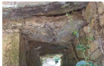
Fracture du tablier, affaissement
