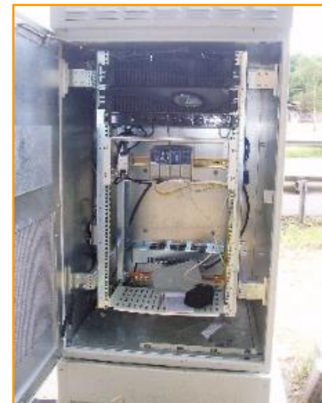
Armoire de mesure vue AR
