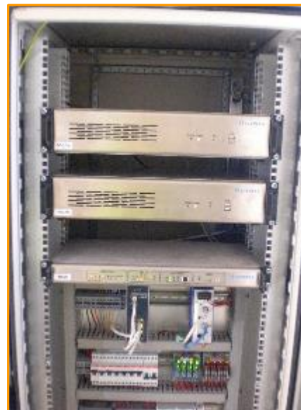
Armoire de mesure vue AV
