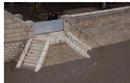
Batardeaux – SYMADREM Source : Guide international sur les digues, CEREMA
