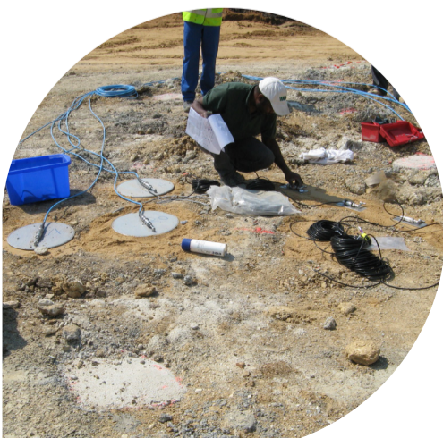
Instrumentation de fondations d'éolienne
