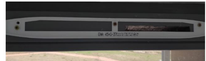
Photo de l'entaille réalisée dans la menuiserie en nombre insuffisant et sous-dimensionnée
