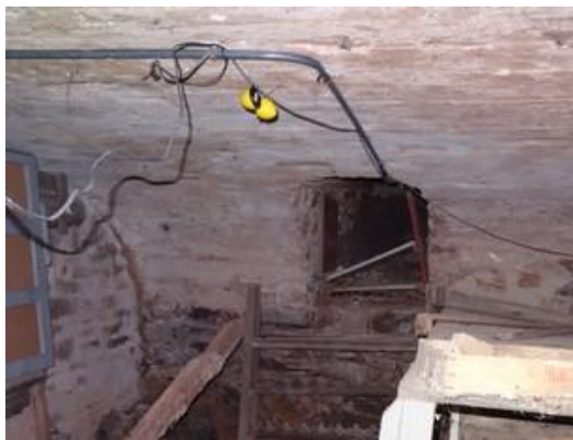
Mesure intégrée avec DSTN dans la cave de la gendarmerie de Tramayes
