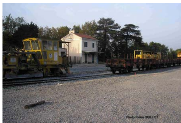
Figure 5 - Matériel utilisé pour la reconstruction de la ligne : à gauche niveleuse, à droite train de travaux (source : FNAUT Pays des Maures)
