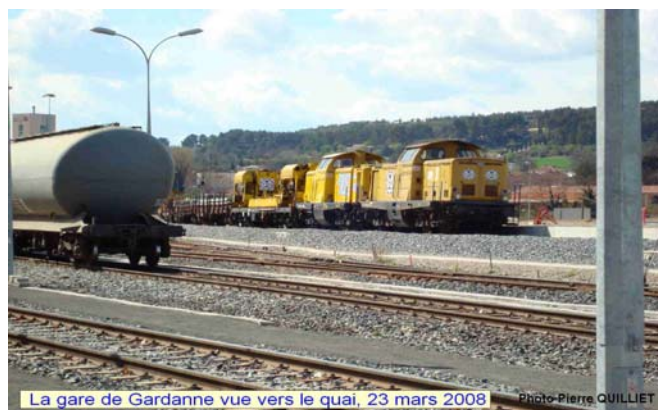
Figure 3 - Train de chantier TSO tiré par 2 locomotives (source : FNAUT Pays des Maures 20 )
