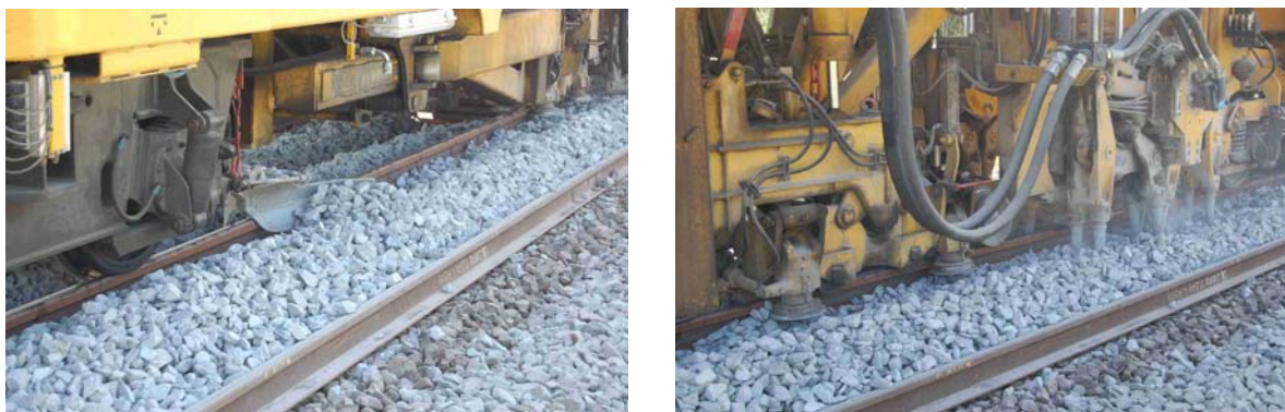
Figure 8 - Illustration de la mise à niveau de la voie (Source : CETE Nord-Picardie)
