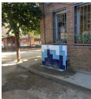
Robinetts extérieurs - école Mare Nostrum, Barcelone
