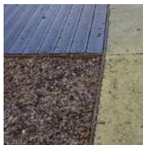
Limite entre copeaux, platelage et béton drainant avec une lisse en bois
