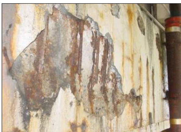
Figure n°4 : État très dégradé d'un parement de chevêtre de pile
