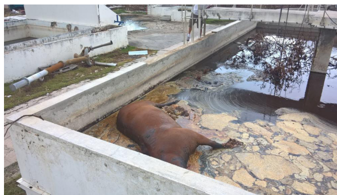
STEP Quartier d'Orléans détruite Source: Établissement des Eaux et de l'Assainissement de Saint-Martin
