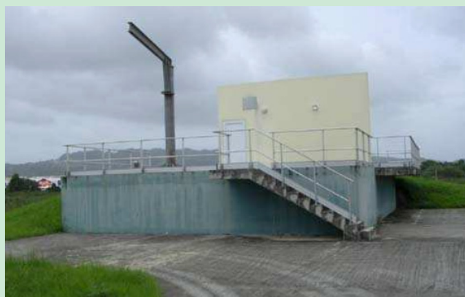
Poste de refoulement Petit Manoir (Source RAD CACEM 2010)
