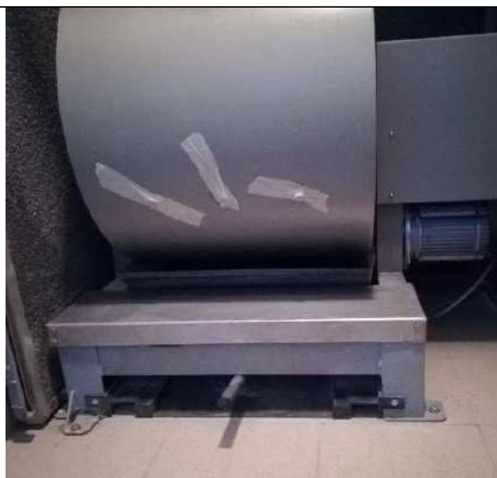
LA = 18,1 Type CONTROLS Bâti métallique fixé au sol
