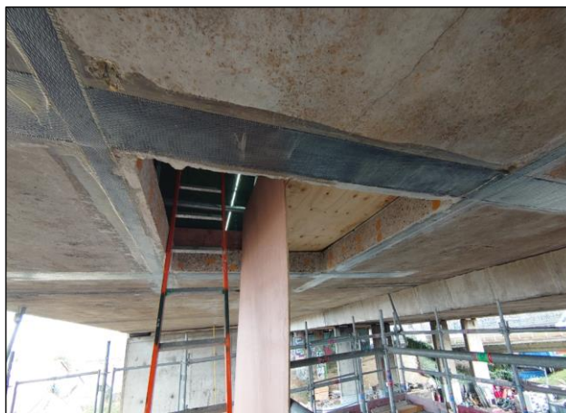
Figure n°27 : Trémie d'accès avec renforcement périphérique en TFC
