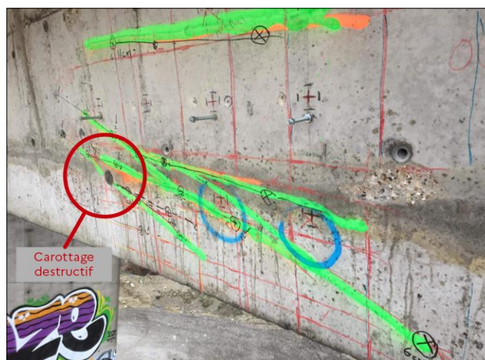
Figure n°35 : Repérage armatures (orange avant dégradation, vert second passage après dégradation)
