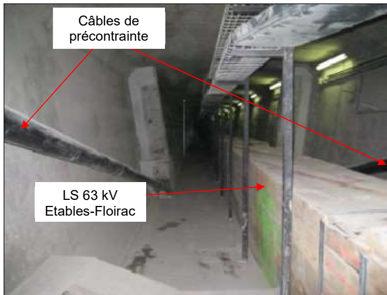
Figure n°4 : Tablier du pont Saint-Jean à Bordeaux, avec câbles de précontrainte à proximité de la liaison souterraine 63 kV de RTE
