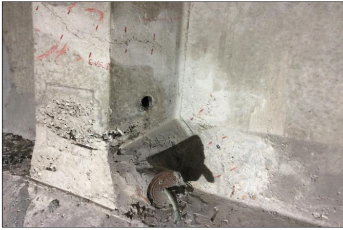
Figure n°12 : Fissure traversante voussoir 3S3
