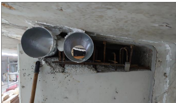
Figure n°45 : Bétonnage défailant du déviateur neuf ouest
