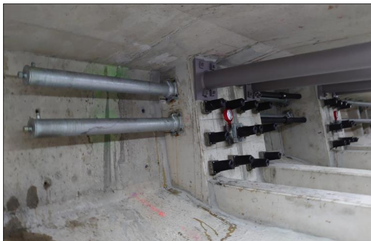
Figure n°48 : Capot de protection des sur-longueurs de câbles
