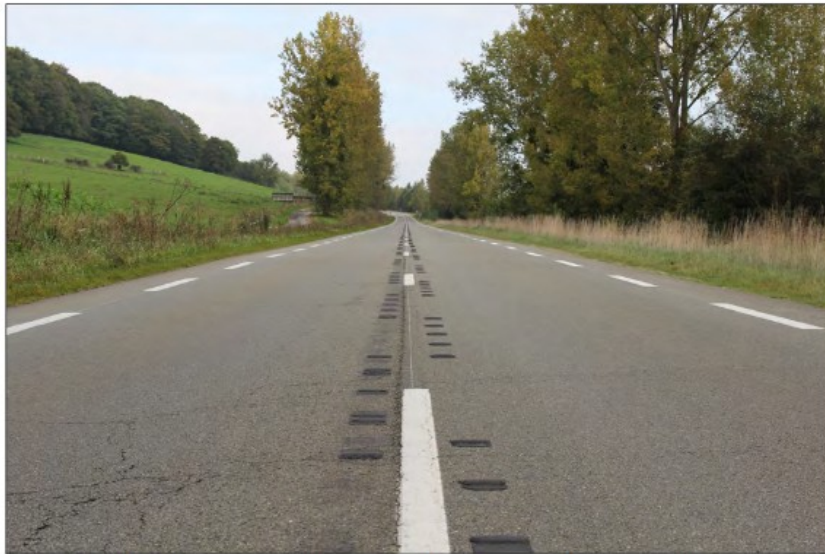
Illustration 12 : RD490 - Chaussée mono-déversée : réduction des largeurs de voies au profit d'une bande désasée de droite - Mise en œuvre de bandes d'alerte sonores de part et d'autre de la ligne axiale (Source : Cerema Normandie-Centre, 2014)
