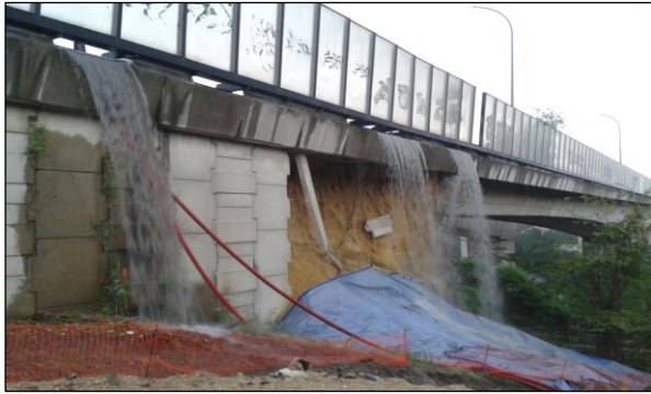
Figure 14 : Défaillance du système d'assainissement au droit de la zone effondrée
