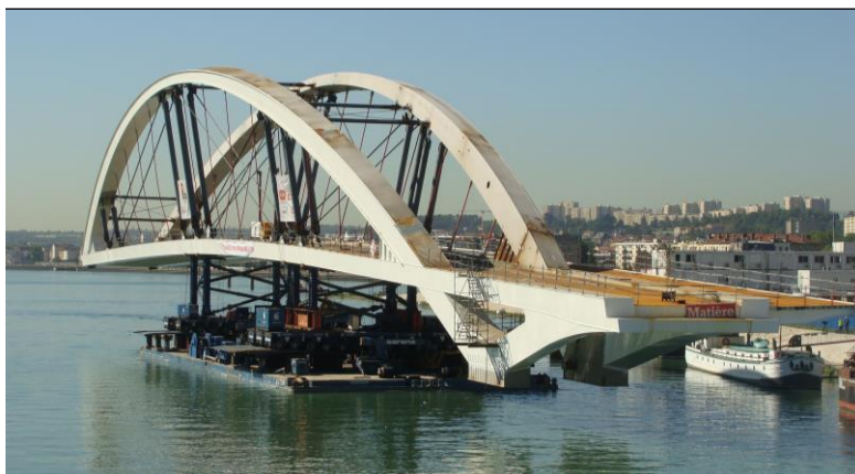
Photo 30 : Transport sur une unique barge de la travée centrale du pont Raymond Barre, à Lyon (69)
