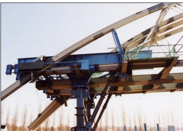
Photo 23 : Renforcement d'un arc à tablier intermédiaire par une charpente provisoire (en bleu sur la photo)
