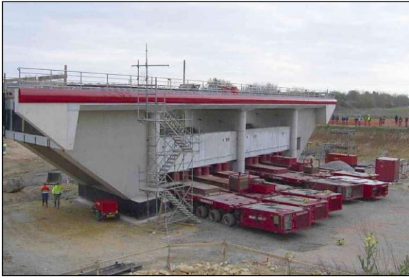
Photo 1 : Mise en place d'un ouvrage complet en béton de type portique double
