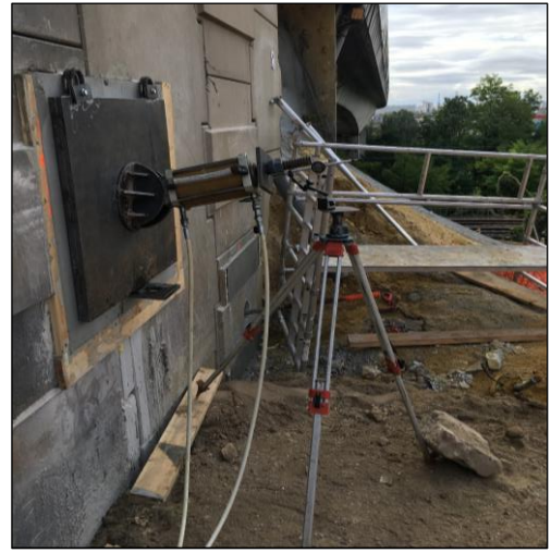
Figure 26 : Essai de traction réalisé à proximité de la zone effondrée
