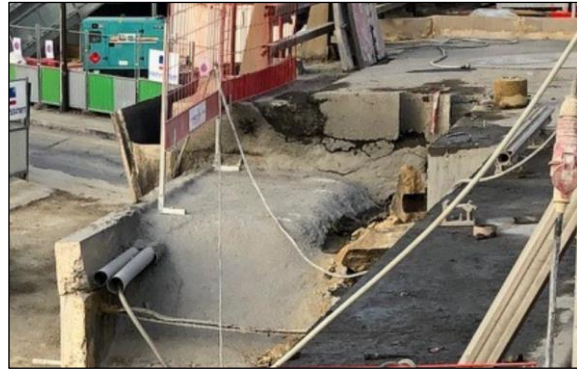
Figure 15 : Interruption des réseaux de l'A15 au droit de la dalle de frottement
