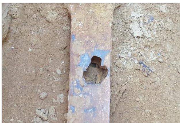
Figure 11 : Corrosion perforante d'une armature de Terre Armée
