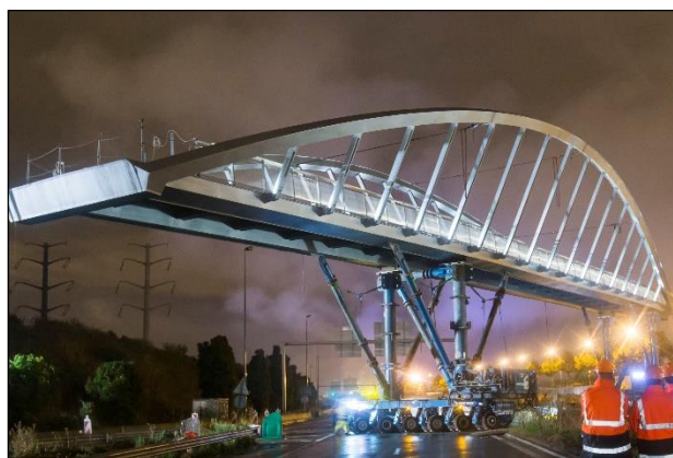
Photo 10 : Palée avec poteaux, béquilles et traverses supportant le tablier en acier d'une passerelle en arc
