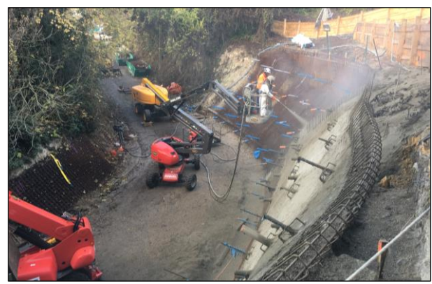
Figure 31 : Mise en œuvre du béton projeté sur le massif renforcé en Texsol
