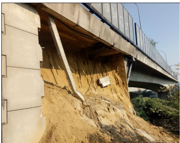
Figure 6 : Vue détaillée de l'effondrement
