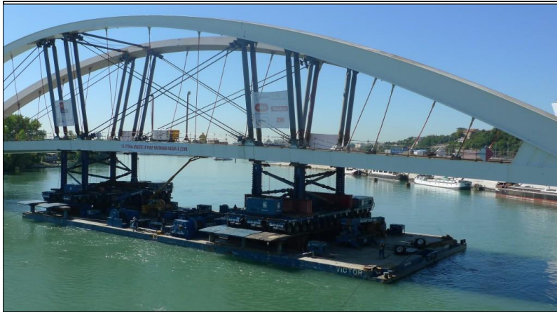
Photo 25 : Haubanage provisoire mis en œuvre sur la grande travée du pont Raymond Barre, à Lyon
