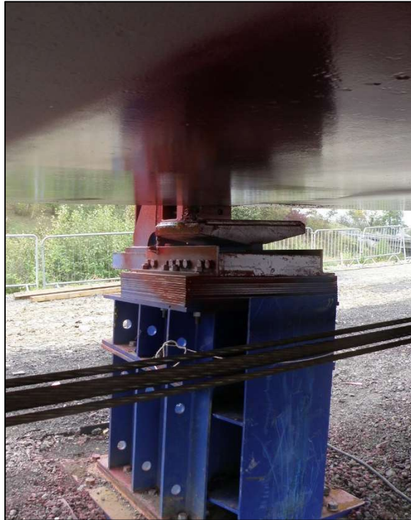
Figure 24 : Décollement d'appui (Cerema NP)
