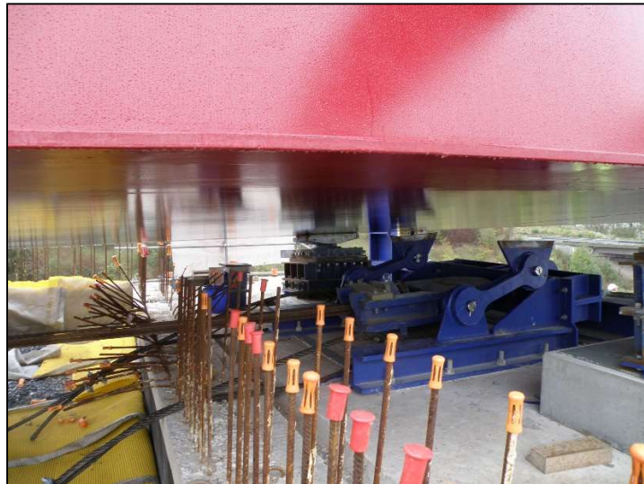
Figure 21 : Treuil métallique installé sur la culée C0 (Cerema NP)
