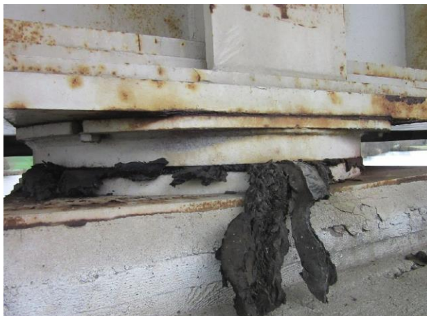
Figure 5. Appareil d'appui sur P1 côté Aval : extrusion du caoutchouc et déformation de la platine inférieure
