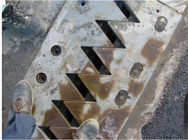
Figure 19 : Joints de chaussée sur culée Rive Droite lors de la réfection de la bande de rive sens Metz- Nancy - Mise en contact des dents, les éléments de joint côté mur garde-grève sont desserrés
