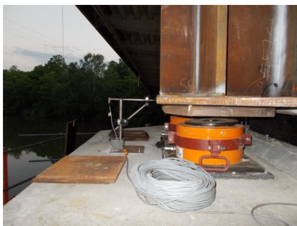
Figure 16 : Capteur de déplacement pour le suivi transversal du tablier sur pile
