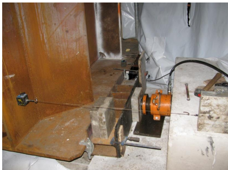
Figure 11. Dispositif de mise en butée latérale du tablier sur culée – Ici avec interposition d'un vérin hydraulique
