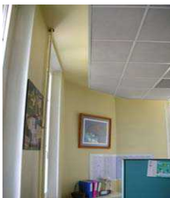
Illustration 54 : Exemple de jeu périphérique entre les parois d'un bâtiment et le plafond suspendu (Source : CEREMA Méditerranée)
