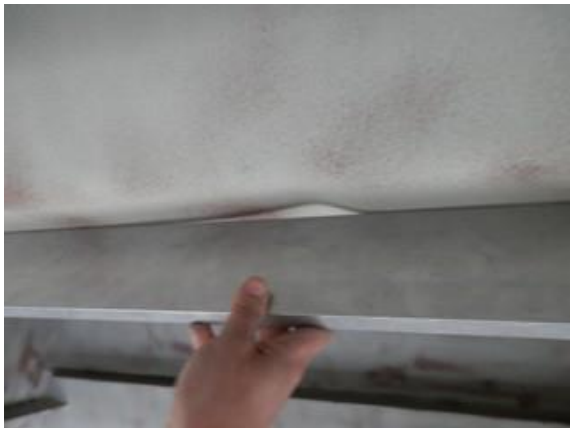
Figure 19 : Auget déformé - Source : Cerema
