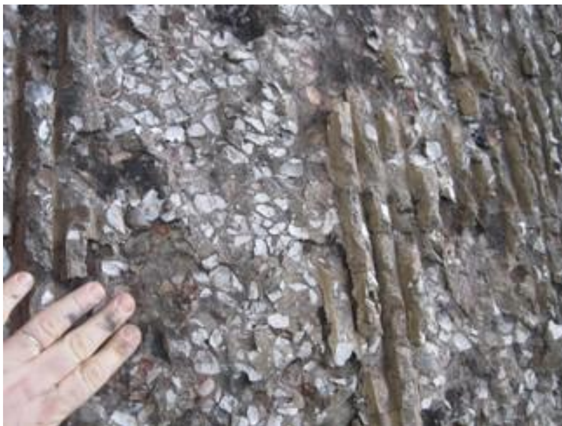
Figure 9 : Ecaillage du béton de la culée avec coloration de certains granulats - Source : Cerema
