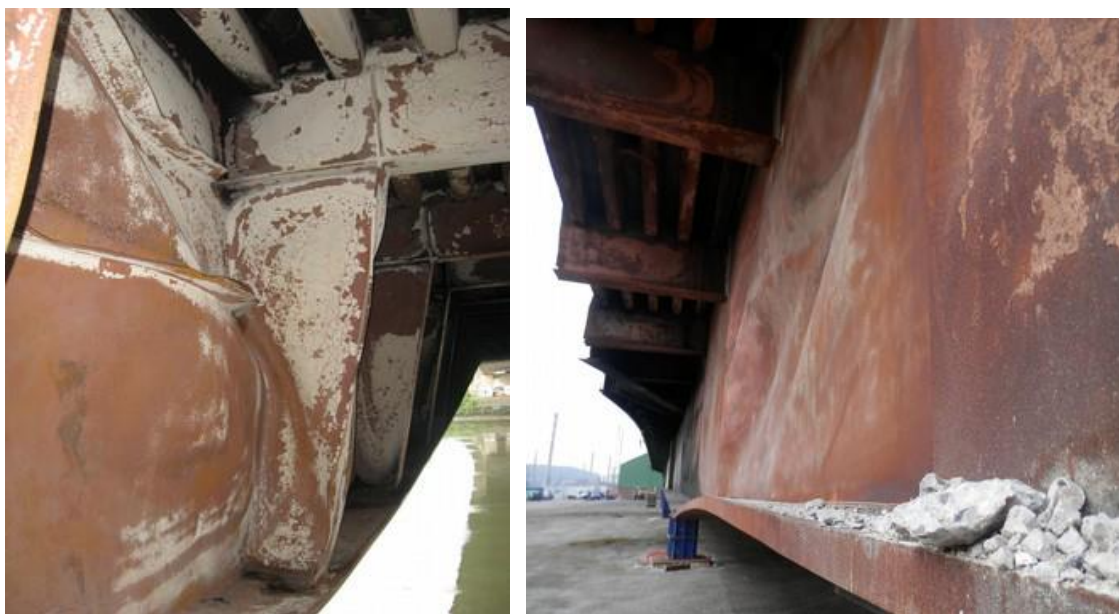
Figure 5 : Déformation de la poutre aval - Source : Cerema
