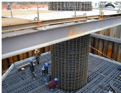
Figure 11 : Densité de ferrailage très importante en pied de fût de pile (source : Cerema / DTerMed)
