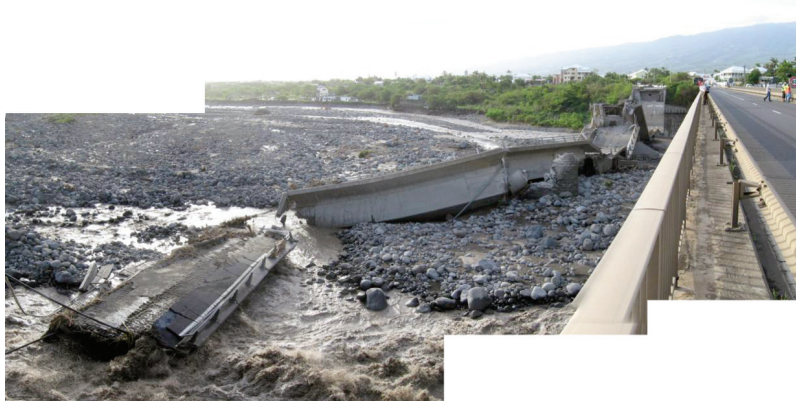
Photo 2 : l'ouvrage aval effondré
