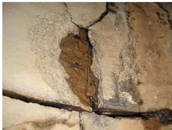
Photo 4 : éclatement du béton du fil d'eau et corrosion d'armatures Source : Pascal Poyer entreprise ETC
