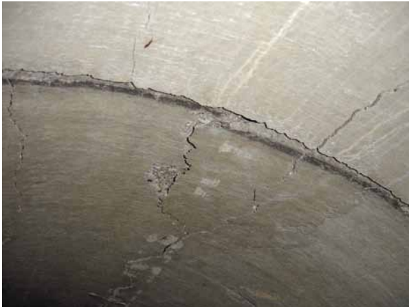
Photo 2 : fracturation en clef Source : André Moutengou (DIRA)
