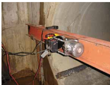
Photo 15 : treuil 12 volts fixé dans le regard aval Source : André Moutengou (DIRA)
