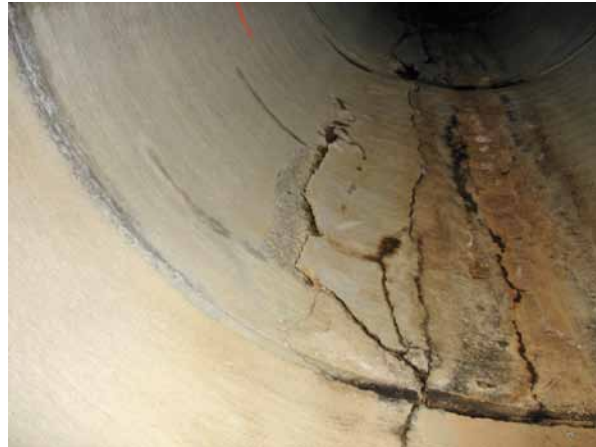
Photo 3 : fracturation avec éclatement de béton au droit du fil d'eau – Source : André Moutengou (DIRA)
