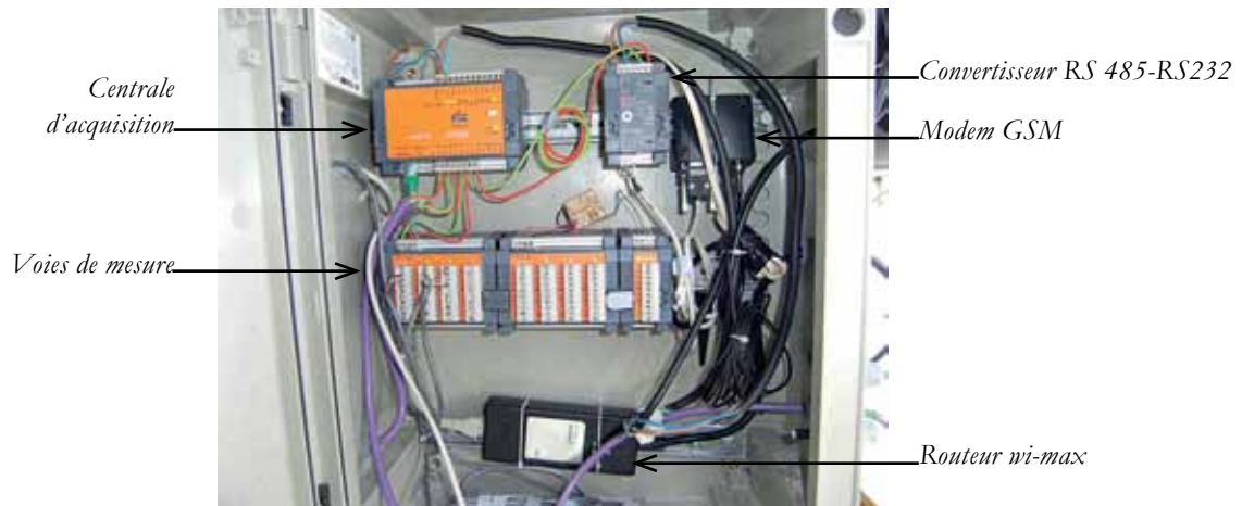
Figure 15 : systèmes de mesure et d'alimentation – Source : LRPC de Bordeaux
