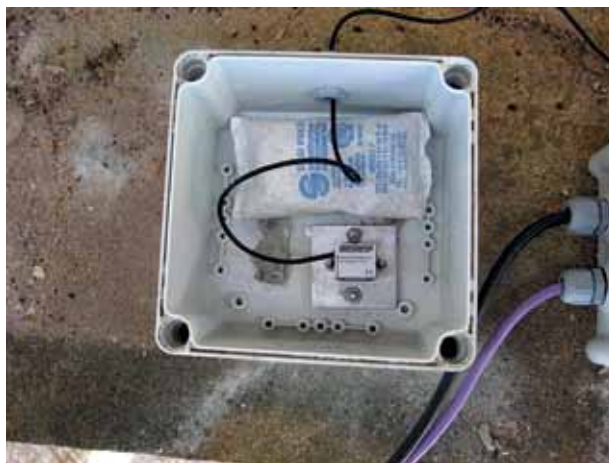
Figure 14 : capteur dans son boîtier – Source : LRPC Bordeaux
