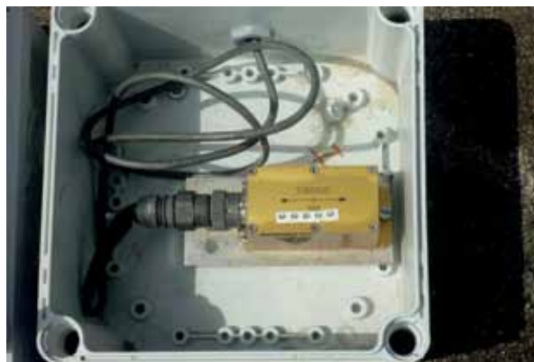
Figure 6 : inclinomètre dans son boîtier de protection Source : LRPC Bordeaux
