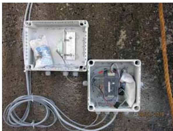
Figure 9 : pile 13 - capteur et module d'acquisition Source : DDE 973
