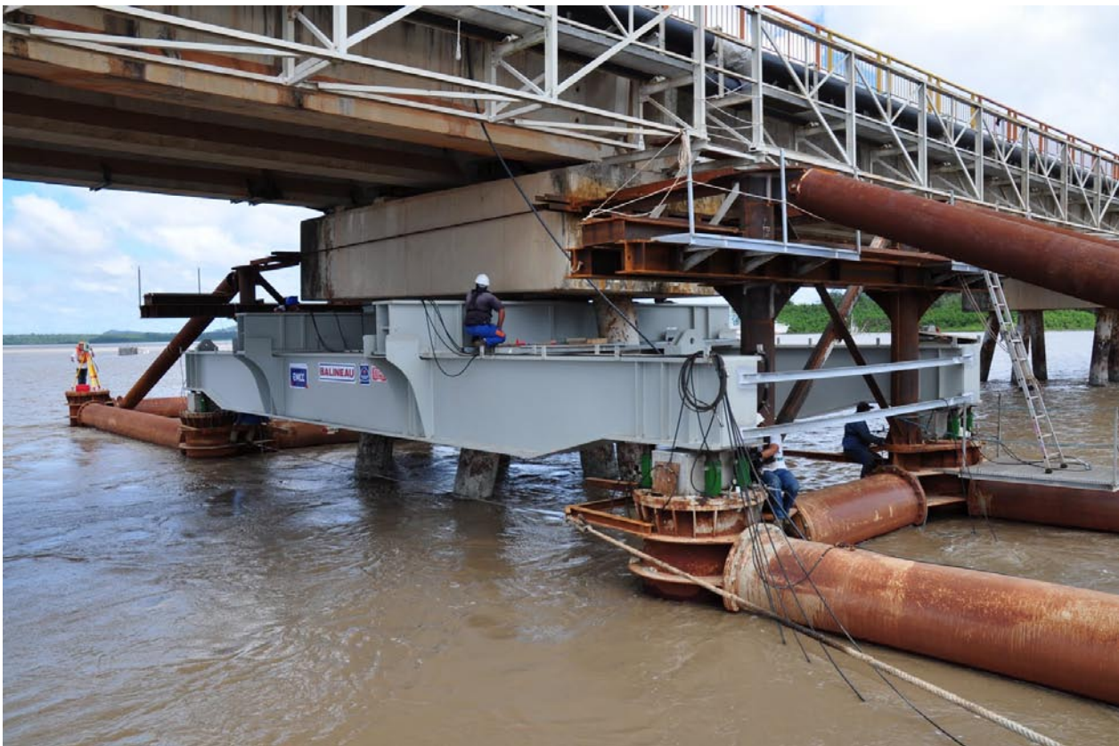
Figure 12 : Vue générale après vérinage – source : DDE 973
