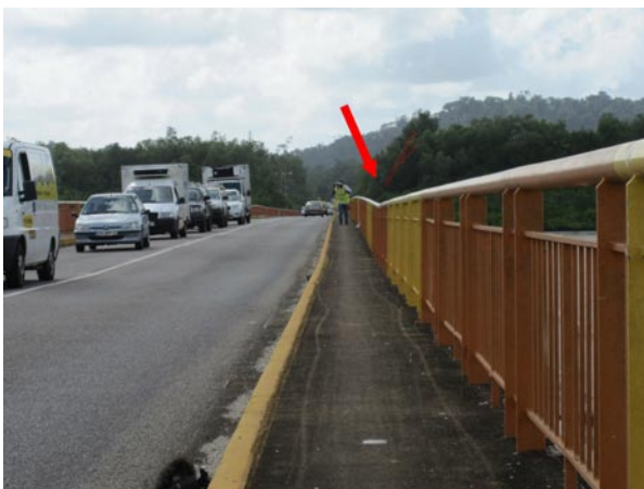
Figure 3 : Vue du garde corps déformé source : DDE 973
