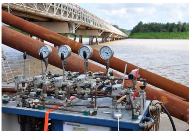
Figure 11 : Centrale de commande des vérins source : Sétra
