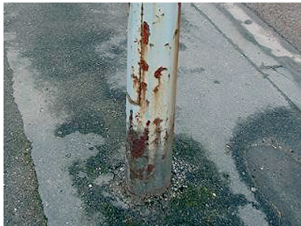
Photo 3 : corrosion (1) – Source : REI-LUX
