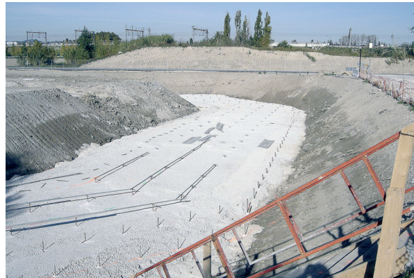
Photo 2 : fondation de la culée C0 sur gros béton – Source : Fernando Dias (Sétra)
