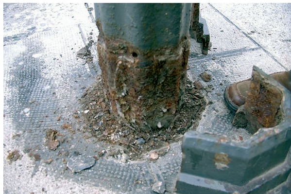
Photo 4 : corrosion (2) – Source : REI-LUX
