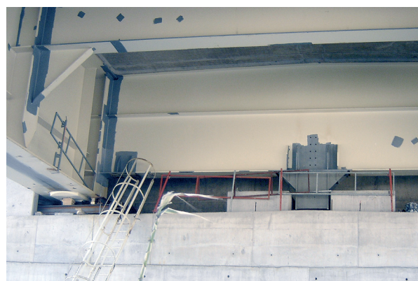
Photo 9 : butées transversales sur la culée C10 Source : Fernando Dias (Sétra)
