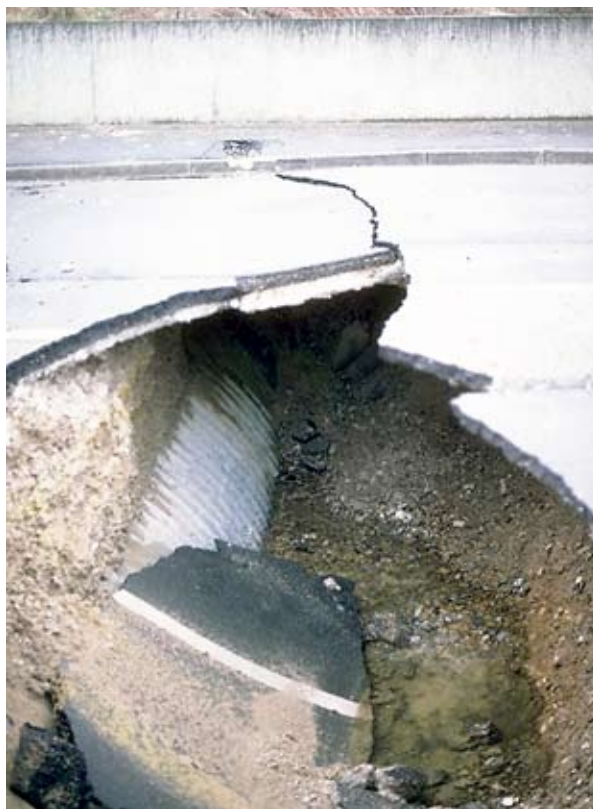
Photo 6 : rupture de la chaussée suite à érosion des remblais contigus Source : Sètra
