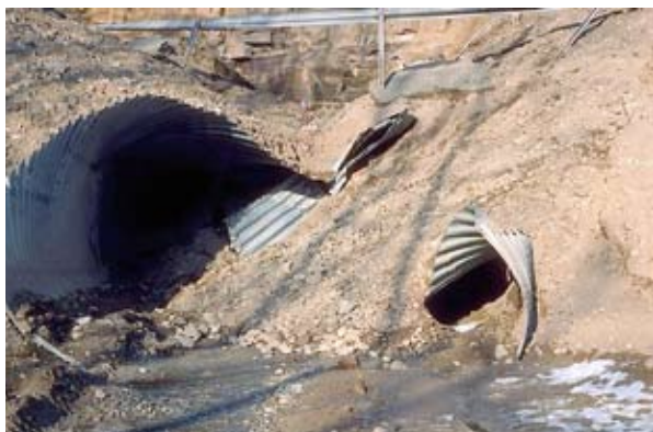
Photos 3 et 4 : effondrement par affouillement – Source : Sétra
