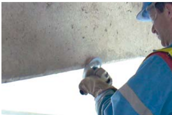
Photo 5 : chanfreinage des arêtes inférieures des caissons par meulage pour former un congé d'au moins 1 cm de côté- Source : LRPC d'Autun
