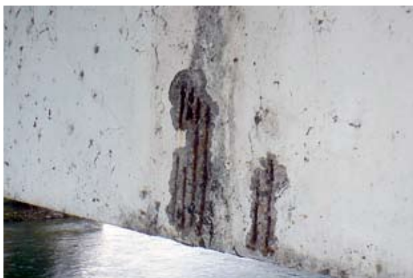
Photo 1 : état initial : béton peint au niveau des faces extérieures des âmes, quelques éclats sur fers apparents corrodés – Source : LRPC d'Autun
