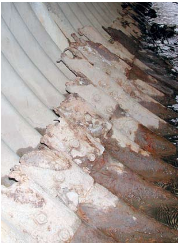
Photo 5 : forte dégradation par corrosion – Source : CETE du Sud-Ouest
