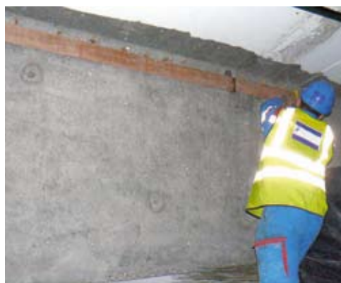
Photo 10 : réalisation d'un gabarit destiné au perçage des plats métalliques – Source : LRPC d'Autun
