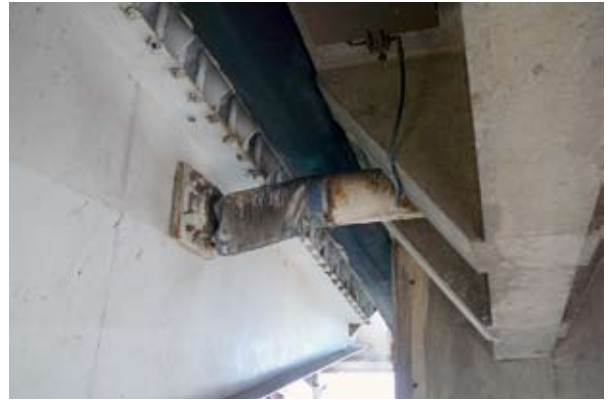
Photo 3 : connecteur dynamique détérioré – Source : Aurélie Vivier (Sétra)
