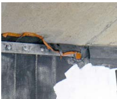
Photo 17 : rabat et collage des surlongueurs des lés de TFC – Source : LRPC d'Autun
