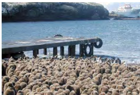
Photo 2 : appontement avant réhabilitation – Source : CETMEF
