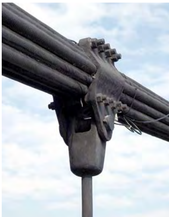
Photo 6 : faisceau de câbles élémentaires – Source : Patrick Losset (CETE du Sud-Ouest)
