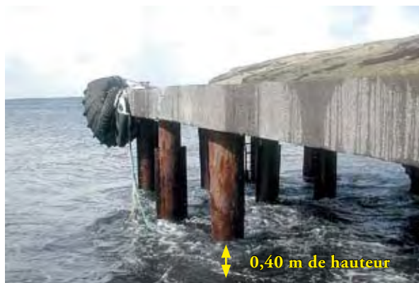
Photo 4 : vu du pieu 5 Nord, complètement détruit sur 0,40 m Source : CETMEF
