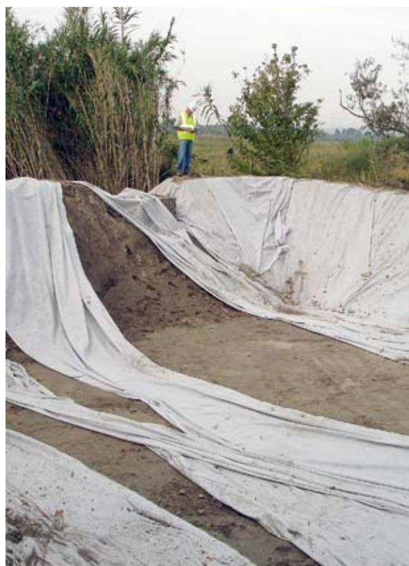
Figure 6 : bassin de rétention provisoire après une crue Source : CETE Méditerranée
