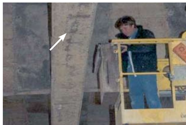
Photo 19 : travée à réparer. Vue d'une fissure avant traitement 11/1991 – Source : Pierre-Marie Dubois, Daniel Michaux (PMD - ATEAV Systems)
