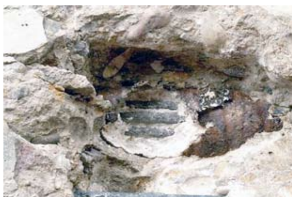
Photo 22 : dégagement du coulis et observation des fils de précontrainte : absence de corrosion sur les câbles de précontrainte – Source : Pierre-Marie Dubois, Daniel Michaux (PMD - ATEAV Systems)
