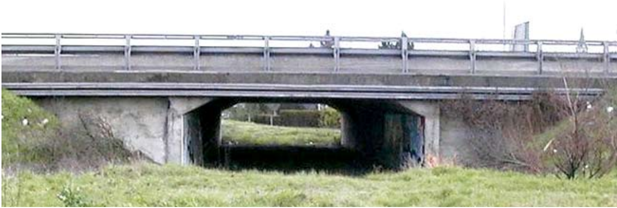
Photo 1 : PICF type, ici « AU51 » (portée 7,40 m ; un des ouvrages de décharge hydraulique de cette zone inondable) – Source : Hervé Marneffe (CETE de l'Est)
