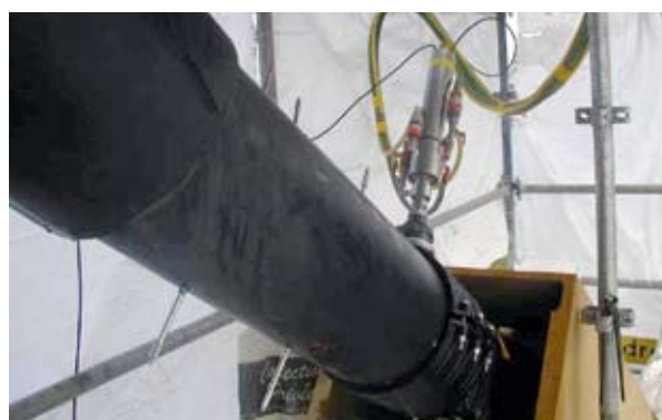
Photo 11 : buses d'injection de solution le long des gaines de protection – Source : Pierre-Marie Dubois, Daniel Michaux (PMD - ATEAV Systems)
