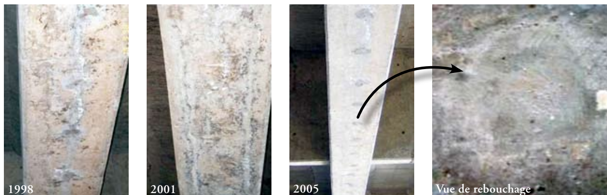
Photos 20 : évolution des poutres traitées au cours du temps, le micro coulis de ciment a fermé les fissures longitudinales causées par les défauts d'injection et aucune évolution d'aspect n'a été constatée – Source : Pierre-Marie Dubois, Daniel Michaux (PMD - ATEAV Systems)
