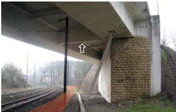
Photo 13 : vue générale et localisation d'une entretoise traitée – Source : Pierre-Marie Dubois, Daniel Michaux (PMD - ATEAV Systems)
