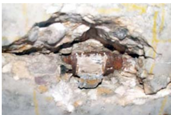
Photo 21 : perçage de l'enrobage de béton et ouverture de la gaine : aucune évolution du coulis réinjecté en 1994 – Source : Pierre-Marie Dubois, Daniel Michaux (PMD - ATEAV Systems)
