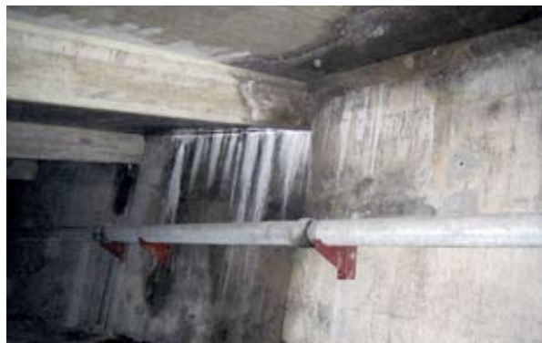
Photo 16 : exemple de zone d'infiltration avec corrosion – Source : Pierre-Marie Dubois, Daniel Michaux (PMD - ATEAV Systems)
