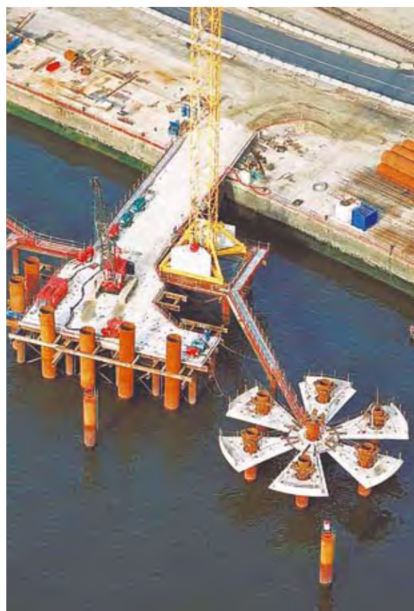
Photo 4 : réalisation du fond de radier d'un gabion à l'aide de sections préfabriquées – Source : Véronique Martins (DDE 76)
