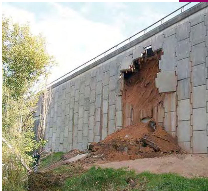
Photo 1 : effondrement local d'un mur de soutènement en terre armée construit en 1974 Source : LR de Strasbourg
