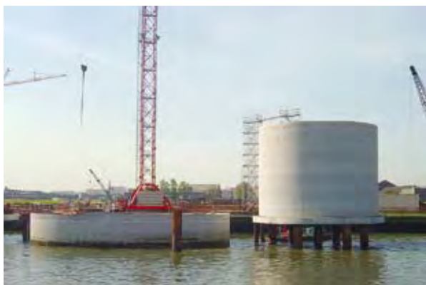
Photo 3 : socle après descente par vérinage (à gauche) et gabion en attente de descente (à droite) – Source : Véronique Martins (DDE 76)
