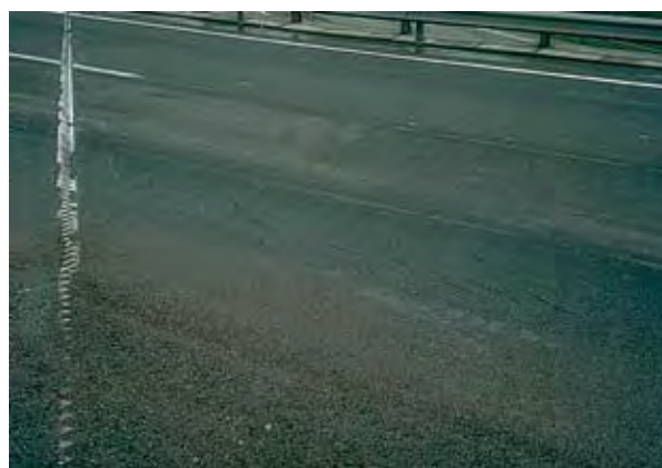
Photo 1 : exemple du glissement d'un complexe étanchéité/revêtement sur une couche de semi-indépendance – Source : Sétra/CTOA
