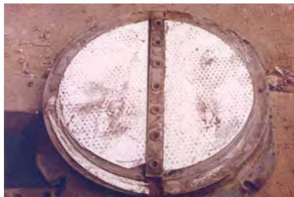
Photo 1 : 1/2 plaque de PTFE d'un appareil à pot avec dispositif de guidage central. Les supports de l'ouvrage étant déformés, l'appareil ne peut remplir son rôle, les plaques cheminent sur leur taquet de blocage puis sont découpées par les mouvements de rotation du tablier Source : Yves Picard
