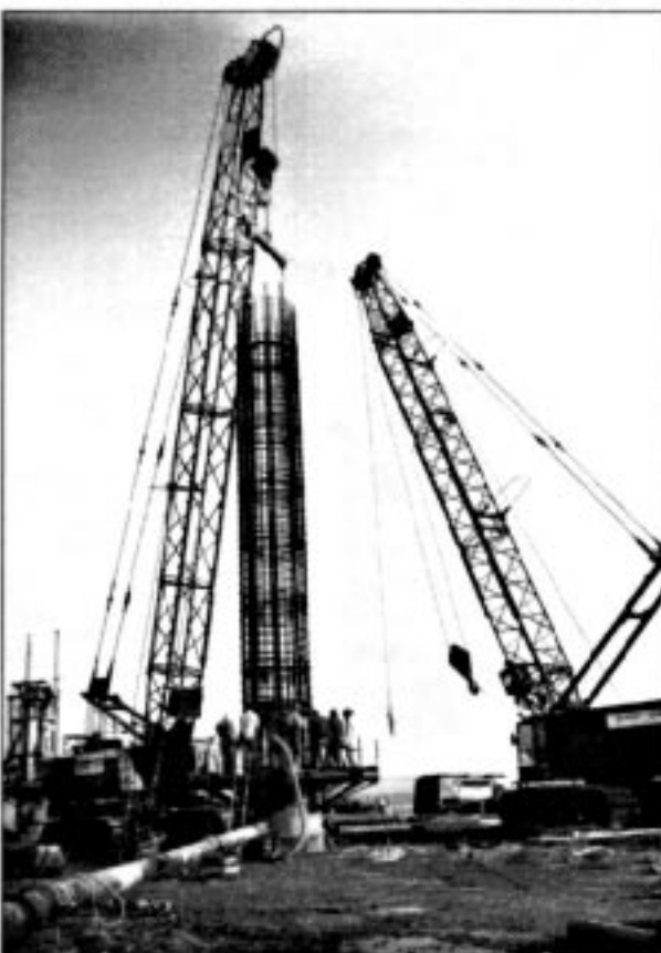
La mise en place d'une cage d'armatures dans les pieux de diamètre 2.100. 4 cages sont nécessaires pour ces pieux de 54 m.
