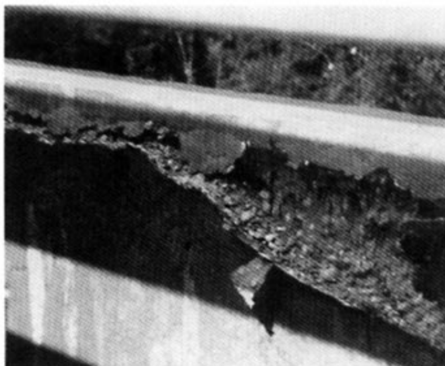
3 ans après la réparation - le béton sous-jacent continue à se dégrader
