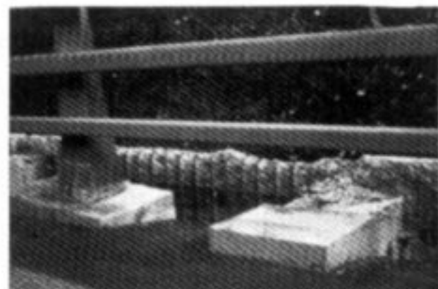
Corniche 7 ans après - réduction de hauteur d'une dizaine de cm.
