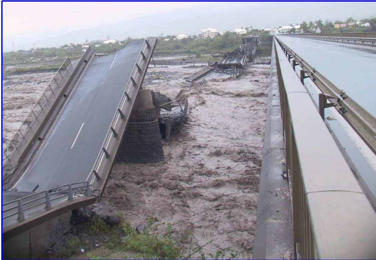
Effondrement du pont de Rivière Saint-Etienne
