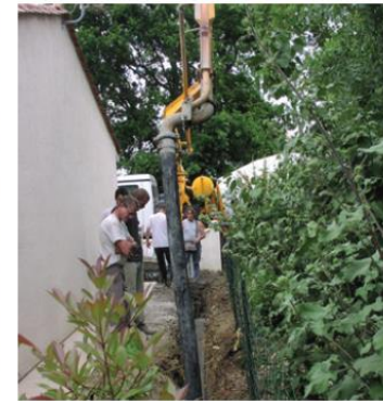
Écran en béton classique (tranchée de 30 cm coulée en béton pleine fouille)
